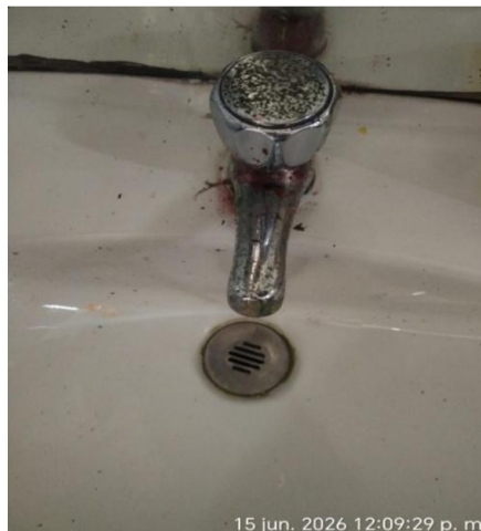
Imagen n.º 85 Grifería oxidada
