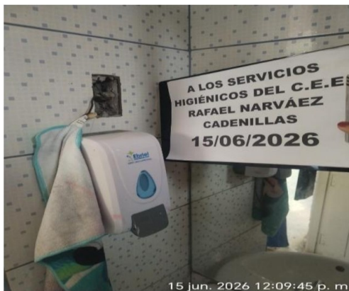
Imagen n.º 86 Cables eléctricos expuestos en interruptor
