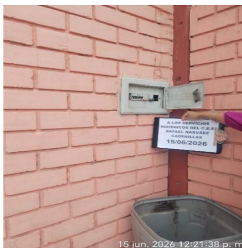
Imagen n.º 99 Tablero eléctrico abierto
