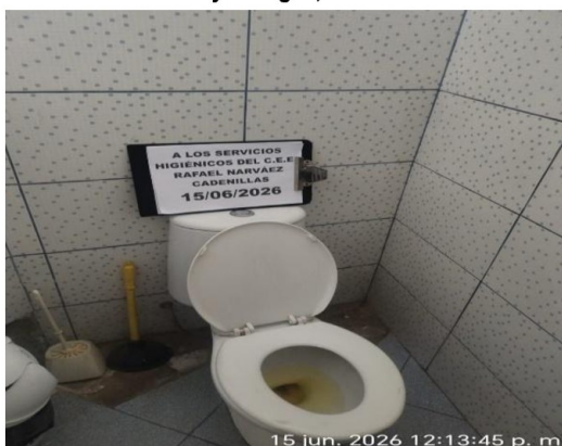
Imagen n.º 79 Inodoro sucio y sin agua, Piso sin cerámica
