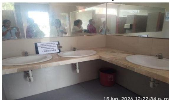
Imagen n.º 100 Lavatorios en SH de mujeres
