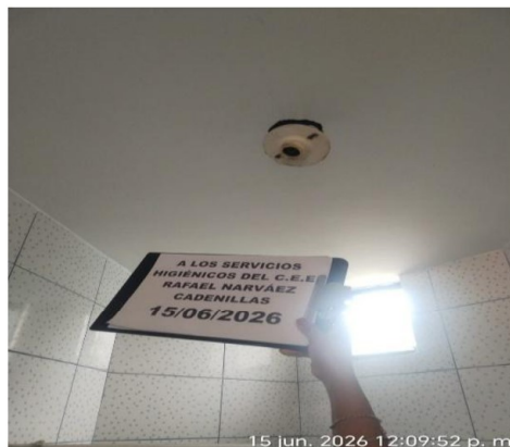
Imagen n.º 87 Salida del luz sin luminaria y desprendida
