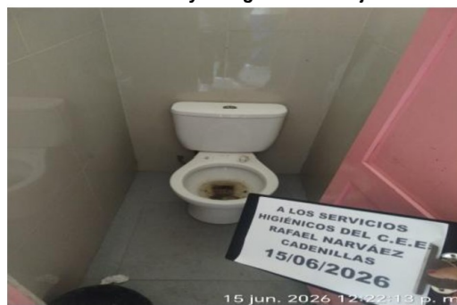
Imagen n.º 101 Inodoro sucio y sin agua en SH mujeres
