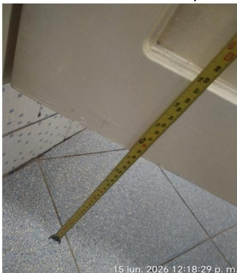
Imagen n.º 95 Puerta ubicada a 29cm del nivel de piso
