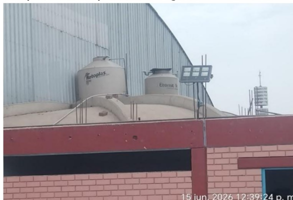
Imagen n.º 97 Tanques elevados que abastecen agua a los SH del coliseo
