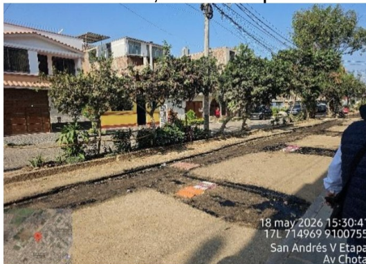
Vista fotográfica n.º 1 Tramo entre los buzones B28 al B9 de la avenida Chota, a nivel de imprimante
