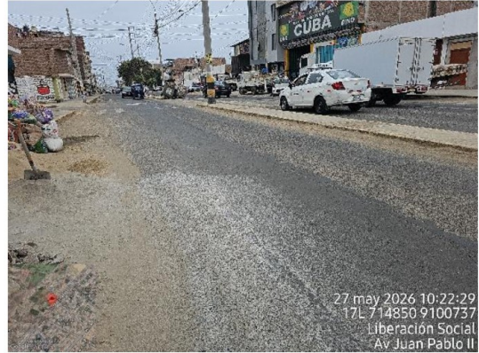
Vista fotográfica n.º 40 La reposición del pavimento presenta asentamiento en la avenida Juan Pablo II
