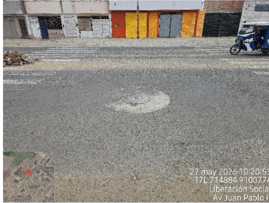
Vista fotográfica n.º 39 La reposición del pavimento presenta deterioro prematuro, en la avenida Juan Pablo II
