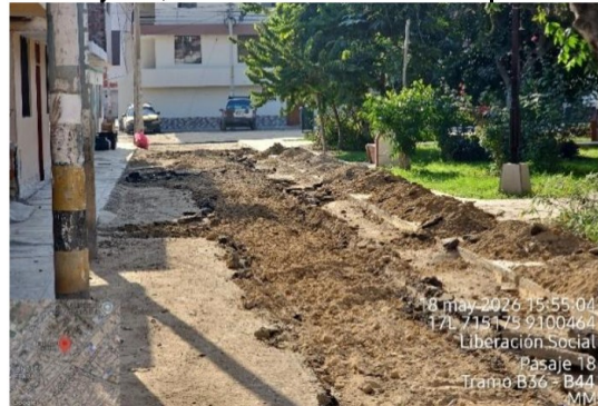
Vista fotográfica n.º 12 Tramo entre los buzones B35 al B44 del Pasaje 18, a nivel afirmado sin compactar
