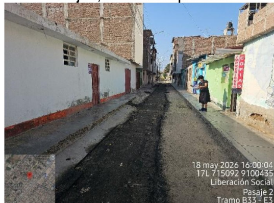
Vista fotográfica n.º 14 Tramo entre los buzones B33 al E3 del Pasaje 2, a nivel de imprimante
