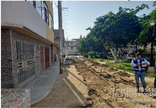
Vista fotográfica n.º 11 Tramo entre los buzones B35 al B44 del Pasaje 18, a nivel afirmado sin compactar
