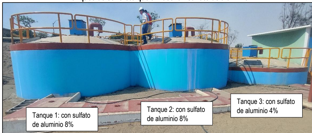
Imagen n.º 3 Tanques de concreto que almacenan sulfato de aluminio
