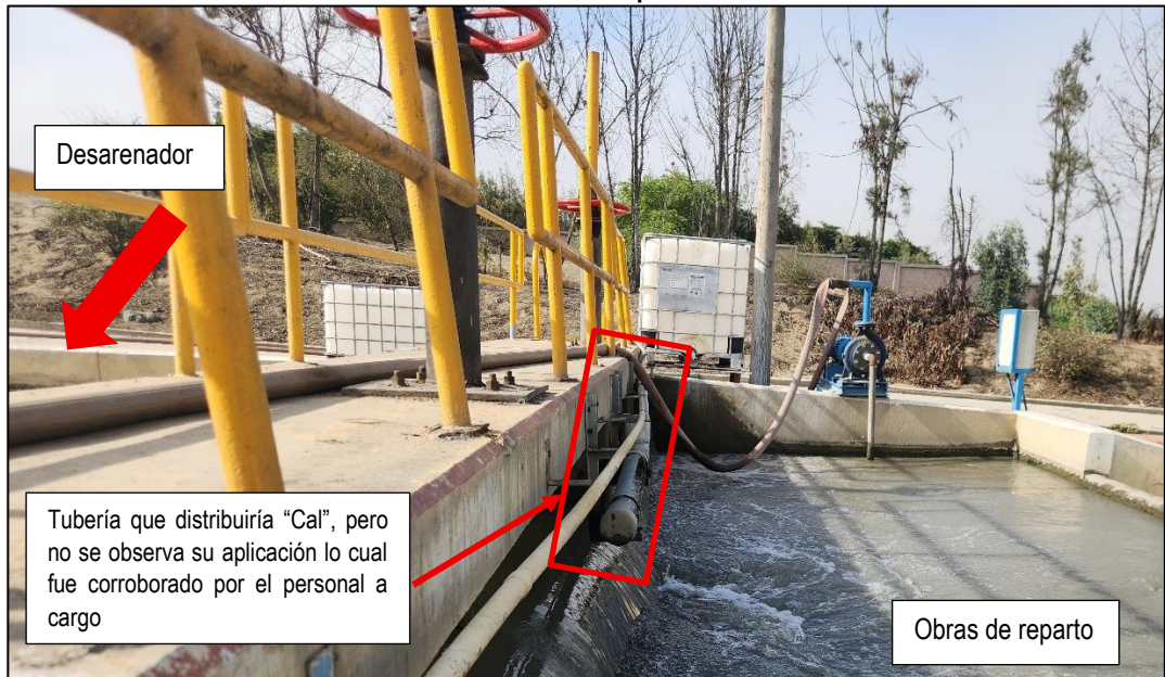
Imagen n.º 2 Sistema existente de aplicación de Cal
