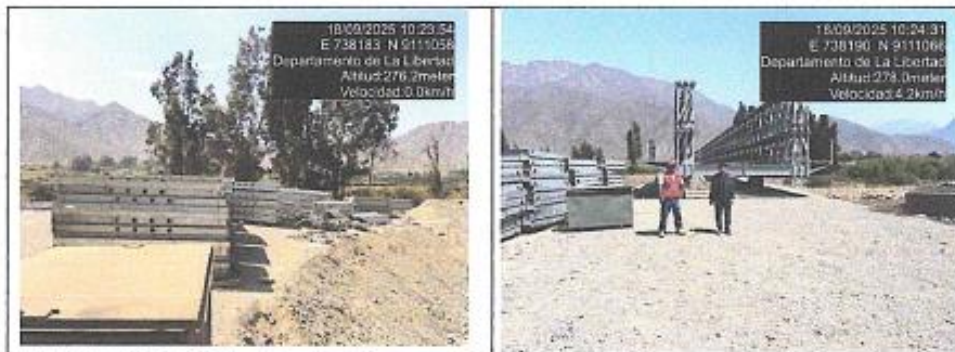
Fotografías n.º 17 y 18: Elementos estructurales que conforman el puente modular se encuentran a la intemperie, pero en la zona de la Obra.
