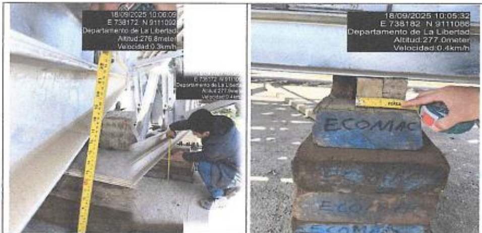
Fotografías n.º 13 y 14: Maderas de estiba que sirven como apoyos temporales, vienen soportando el peso de la estructura desde el mes de mayo de 2025 debido a que no se culminó con el lanzamiento del puente modular por la resolución del contrato de ejecución; y en algunos casos tiene un ancho mínimo de 5 cm, además, se advierte el deterioro del referido material. (Estribo izquierdo)
