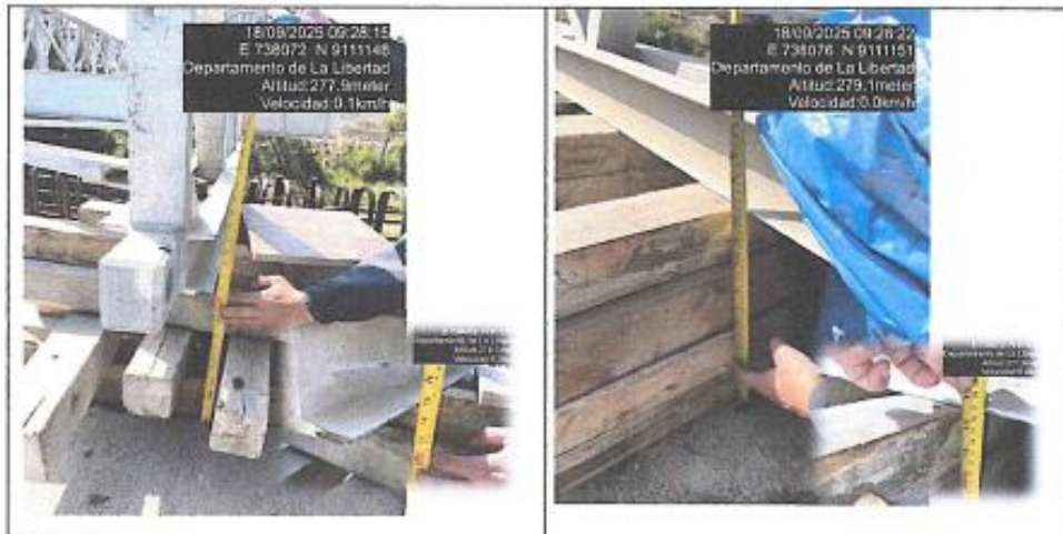
Fotografías n.º 11 y 12: Maderas de estiba que sirven como apoyos temporales, vienen soportando el peso de la estructura desde el mes de mayo de 2025 debido a que no se culminó con el lanzamiento del puente modular por la resolución del contrato de ejecución; y en algunos casos tiene un ancho mínimo de 5 cm, además, se advierte el deterioro del referido material. (Estribo derecho)
