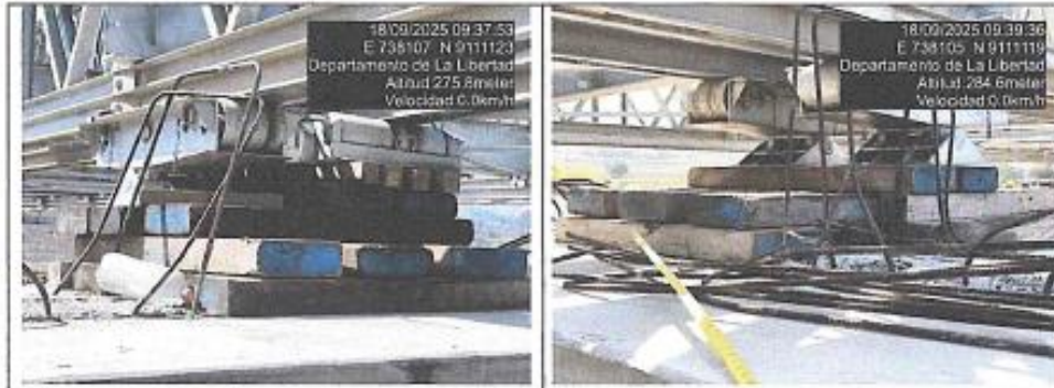
Fotografías n.º 15 y 16: Maderas de estiba que sirven como apoyos temporales, vienen soportando el peso de la estructura desde el mes de mayo de 2025 debido a que no se culminó con el lanzamiento del puente modular por la resolución del contrato de ejecución; y en algunos casos tiene un ancho mínimo de 5 cm, además, se advierte el deterioro del referido material. (Pilar central)
