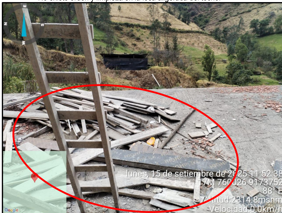
Imagen n.º 19 No existe orden y limpieza en la losa aligerada del techo.
