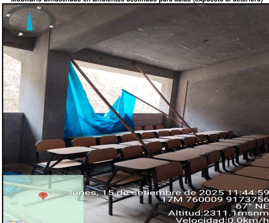
Imagen n.º 12 Mobiliario almacenado en ambientes destinados para aulas (expuesto al deterioro)
