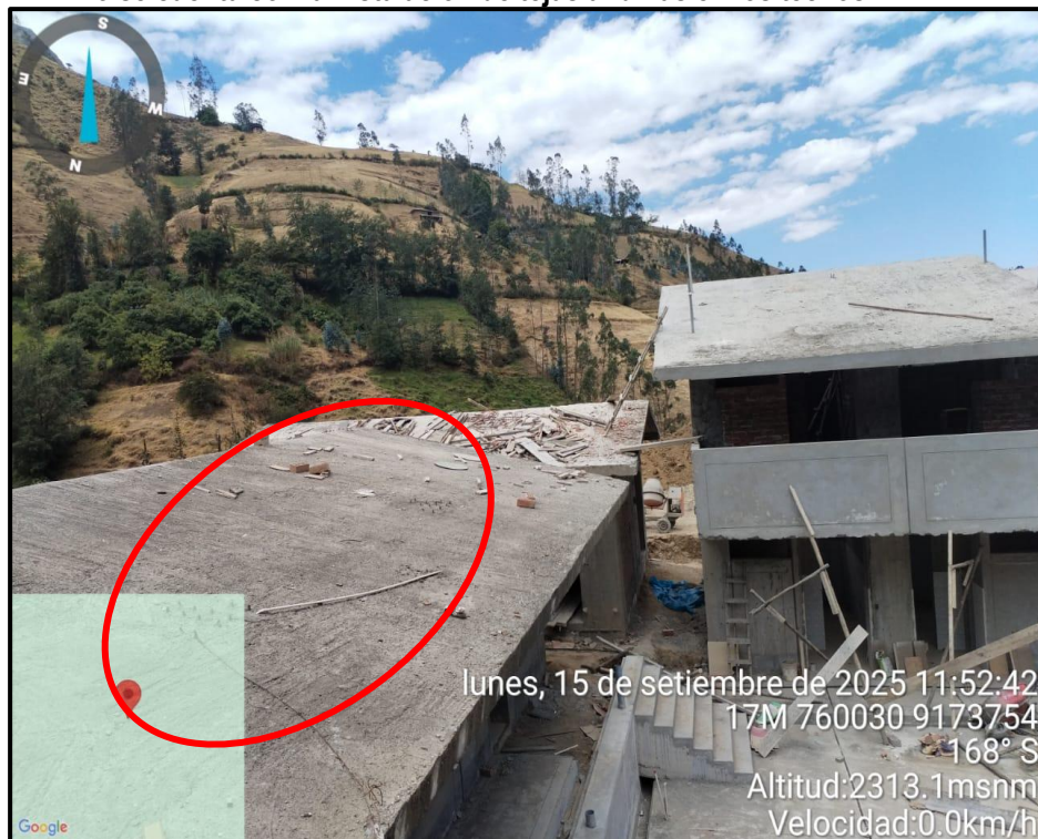
Imagen n.º 18 No se cuenta con la instalación de tejas andinas en los techos.
