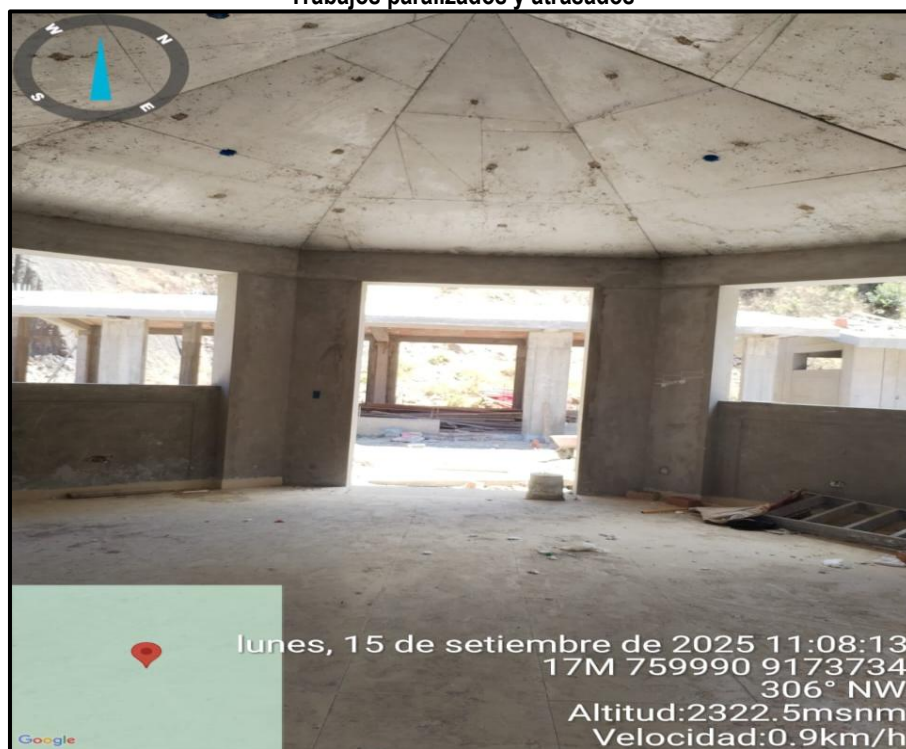
Imagen n.º 5 Trabajos paralizados y atrasados
